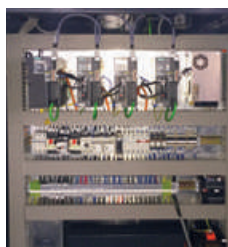
Armadio elettrico . Pannello di comando chiaro e di ampie dimensioni . Motori Siemens . Conforme alle norme
